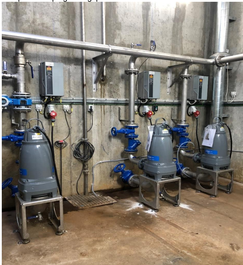
Pumpestation på genbrugspladsen
