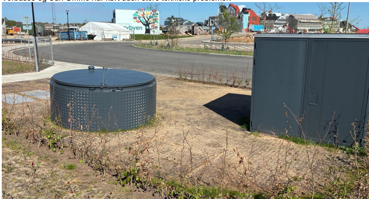
Hovedpumpestation ved Travbyen
